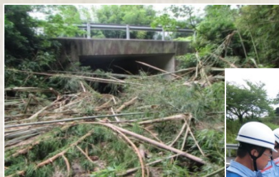
ボックスの一部閉塞 (流木の蓄積がさらに進むと高速道路への影響が懸念されました)
