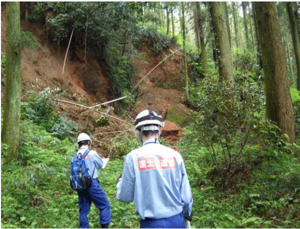
崩落箇所の調査状況
