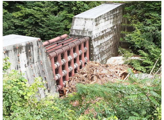
令和5年8月 台風第7号 (瀬戸谷第1砂防堰堤) (2023年) (揖斐川町日坂)
