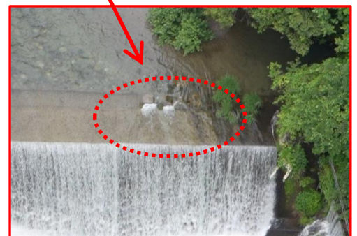
画像を拡大することで、水通し部の損傷（摩耗）を確認
