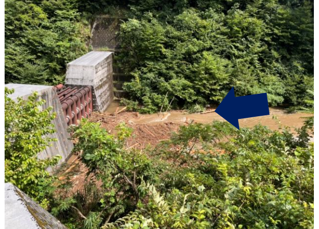
出水後：令和5年8月16日撮影
