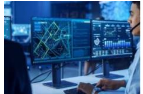
遠隔操作・監視
