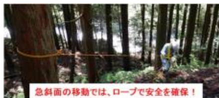
流出した土砂や流木で、移動が困難
