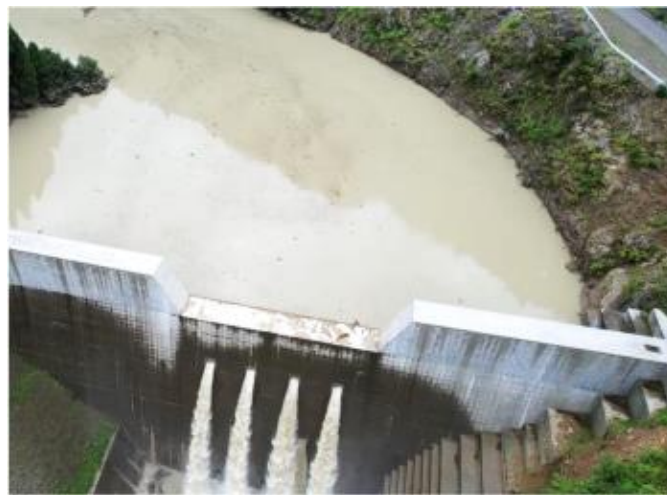
令和5年8月 台風第7号 (高地谷第1砂防堰堤) (2023年) (揖斐郡揖斐川町小津)
