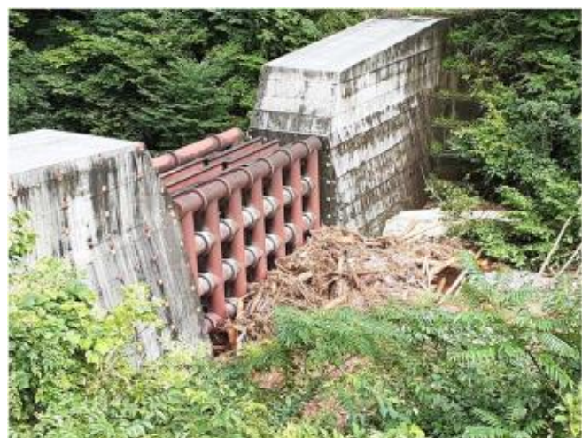
令和5年8月 台風第7号 (瀬戸谷第1砂防堰堤) (2023年) (揖斐郡揖斐川町日坂)
