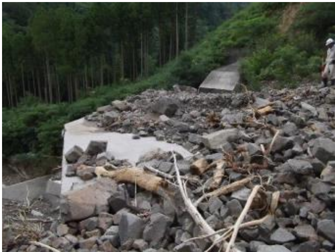
平成23年1月 土石流 (本巢市根尾越波) (2011年)
