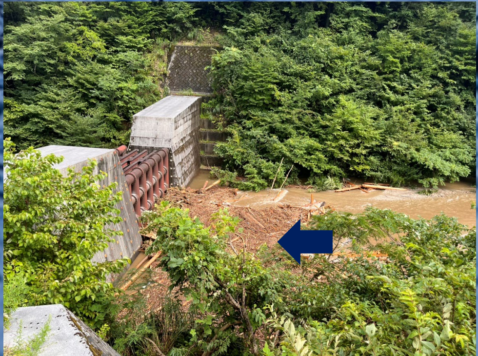
土砂・流木の捕捉状況
