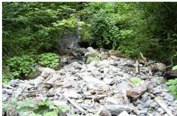
上流部の荒廃状況
