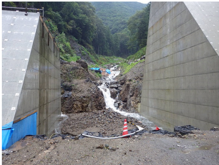
現場内への土砂流入の状況
