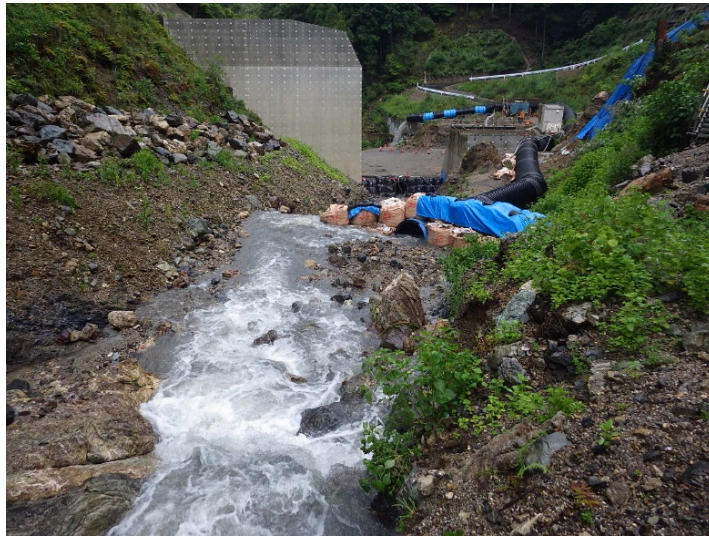
仮締切の破損状況
