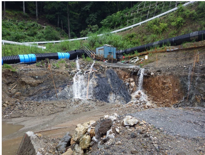
仮水路の破損状況
