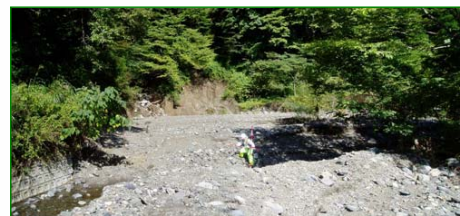
河床堆積状況 勾配が変化する屈曲部に堆積した土砂。 幅 50m×延長 70m×深さ 1m=3,500m 3 程度
