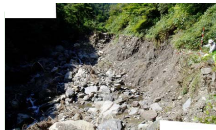
溪岸侵食状況 湾曲部では、溪岸侵食が激しく、林道を寸断し流下している。 幅 5m×延長 50m×深さ 5m=1,250m 3 程度
