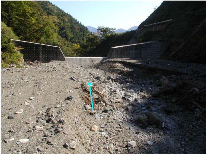
災害後 H20 満砂 約 7,000m3 堆積
