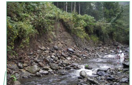
溪岸浸食状況 親谷第3砂防堰堤より下流では比較的小規模な溪岸・溪床の浸食・堆積現象が見られる。 高 4.5\text{m} ×延長 70\text{m} ×深さ 1.2\text{m}=380\text{m}^3
