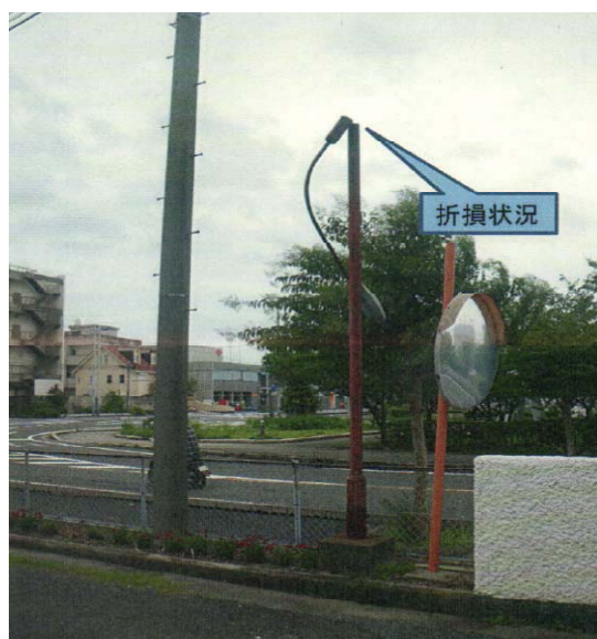
写真5 損傷した外灯
