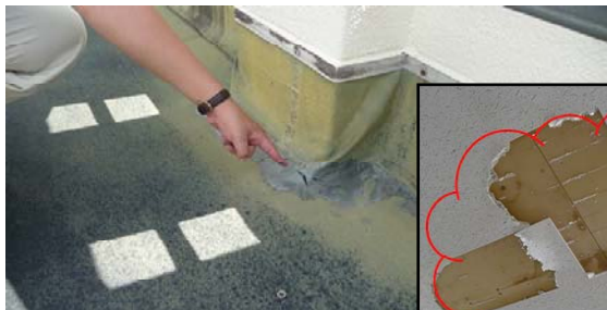
写真1 防水シートの破れ
