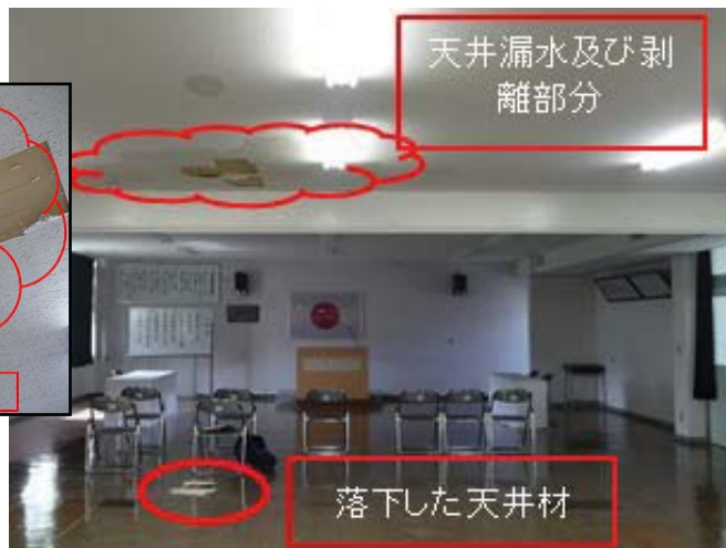
写真3 漏水した室内
