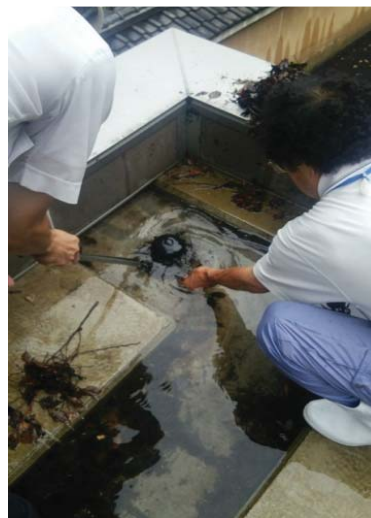
写真4 ドレインの詰まりを解消
