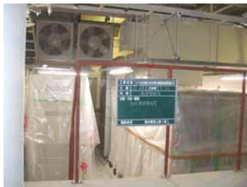
B2階 保安用発電機
