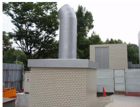
自家発電機用煙突(手前)と電気室の排気塔
