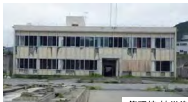
管理棟 被災後
