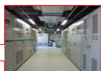
上階に移設した受変電設備
