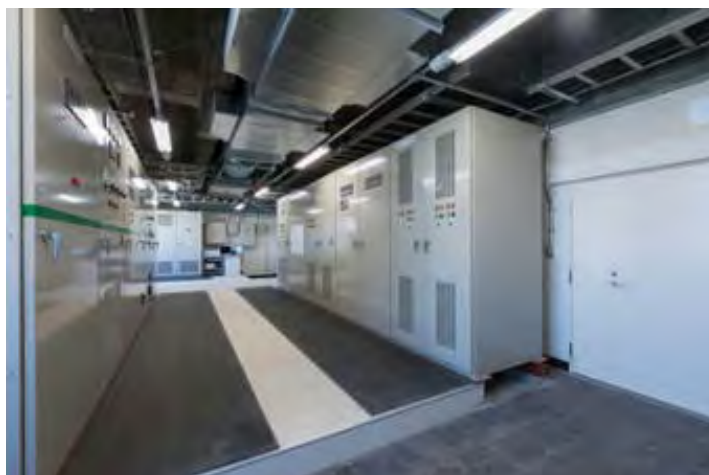
上階に移設した電気室
