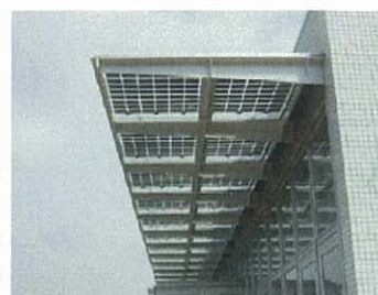
管理棟底部分設置パネル4kW
