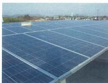
管理棟屋上設置パネル30kW
