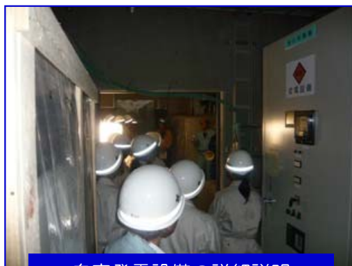
自家発電設備の詳細説明
