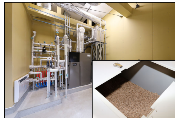
ペレットボイラー
