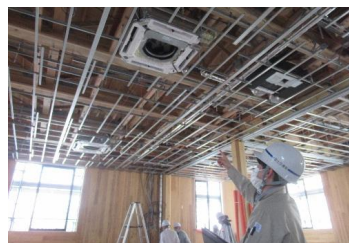
空調設備機器
