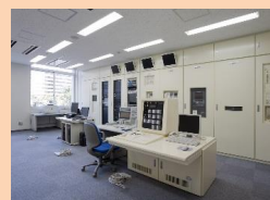
中央監視設備
