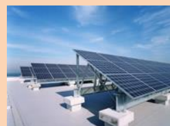
太陽光発電設備
