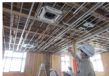
空調設備機器
