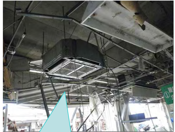
1階事務室内 津波により天井内機器が破壊されている。
