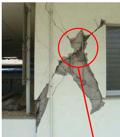
柱のせん断破壊
