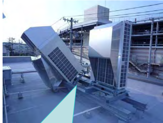
屋上設置の屋外機基礎からボルトが外れて転倒している。
