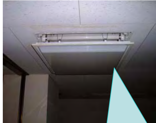
照明器具のカバーの脱落の例
