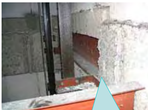
エレベータシャフト内の壁面の耐火材が剥がれ落下
