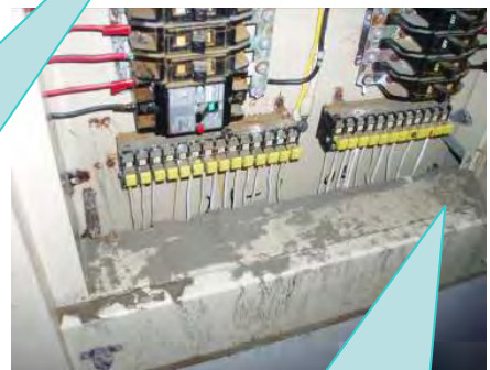
低層階設置の分電盤： 津波浸水を受けているが、据付状 況は問題なし。
