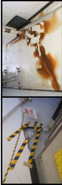
【防災拠点施設の被害】
