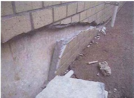
外壁タイル脱落
