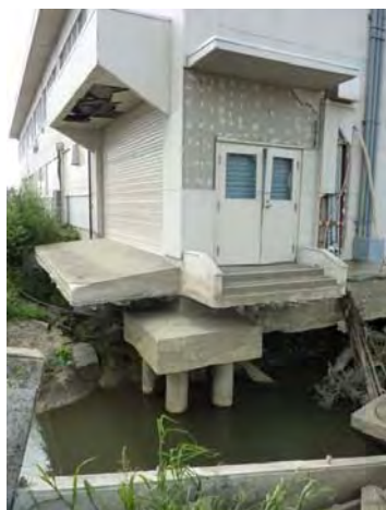
地盤の洗掘による杭頭の露出
