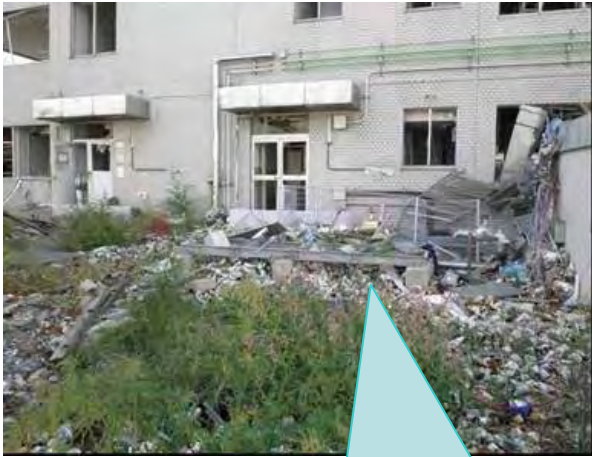
外部 受水槽が津波により流失し基礎のみが残る。
