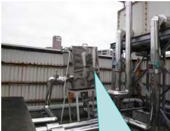
PH階上部 消火用補助水槽は傾いており接続配管も変形している。
