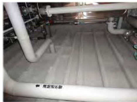
写真5 ポンプ室(Y方向)
