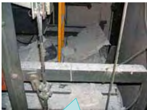
エレベータシャフト内の壁面の耐火材がカゴの上に落下。
