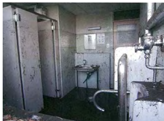
津波による内装の汚損
