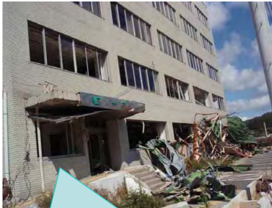
津波による外装被害： 水勢や、流出物の衝突による建具、外装の破損
