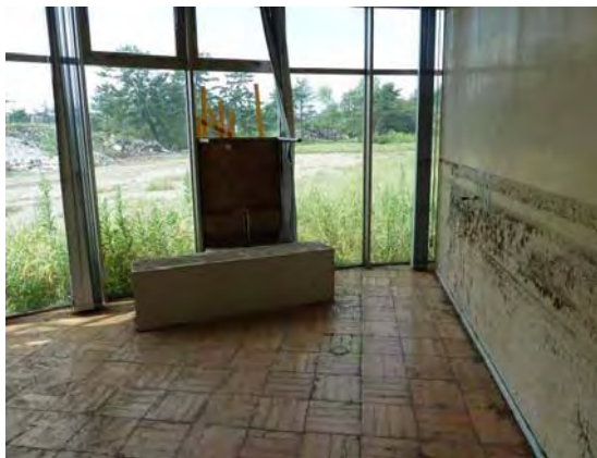
津波による内装の汚損
