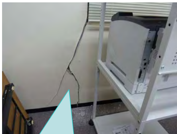
ボード壁に入ったクラック
