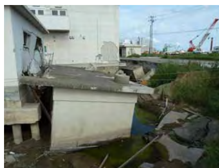
付属建物の流失、隣棟への衝突
