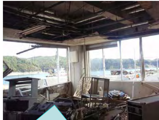
津波による内装被害： 津波により激しく損傷した壁、天井
