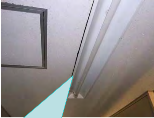
照明器具のずれの例
