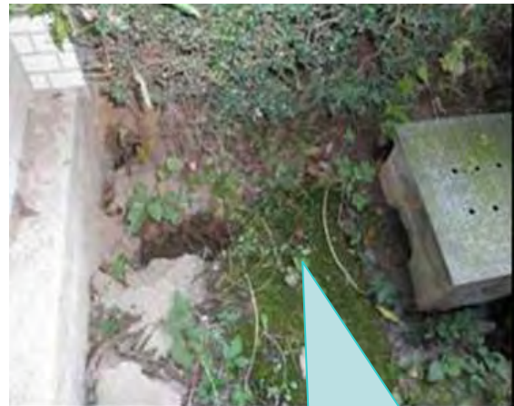
1階外部 排水管と排水桝の間が断絶している(敷地と建物間に最大300mmの段差が生じた)。
