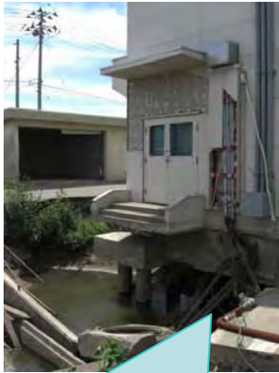
電力引込部分： 地盤沈下、津波によるハンドホール、地中 管路の流失、破断の例
