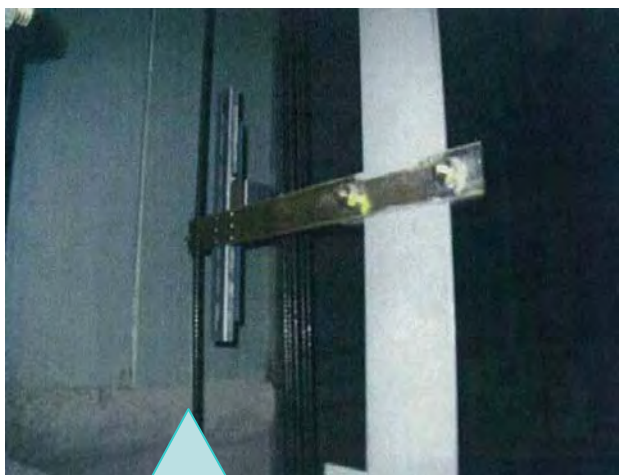
高層EVの主ロープがインダクターの裏に回り込んだ状態。
