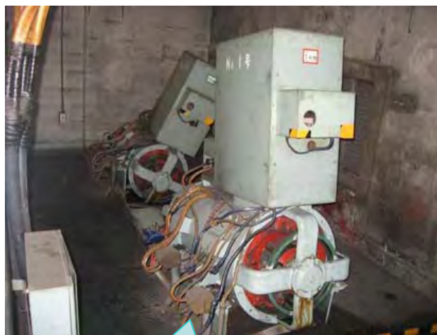
EV機械室の巻上機が転倒。
