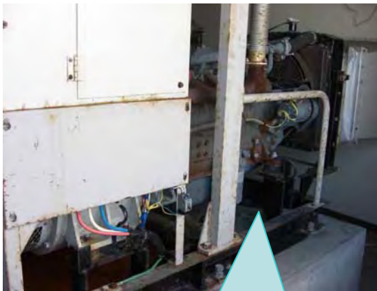
低層階設置の自家発電設備： 津波浸水により自家発電設備が停止。
