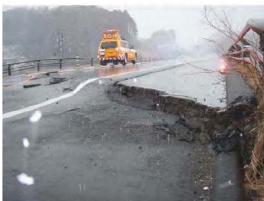
三陸自動車道での段差(石巻市内)
