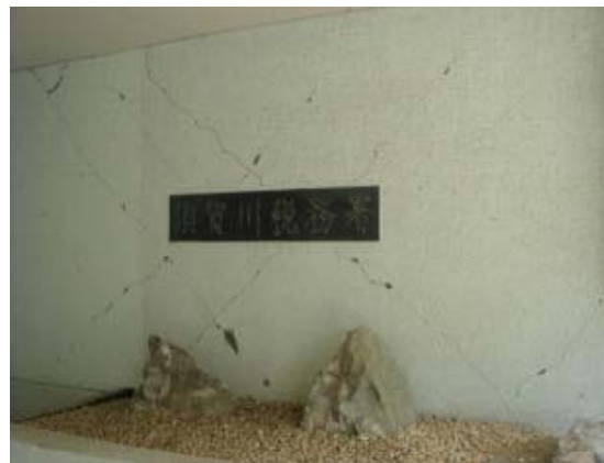
耐震壁のせん断ひび割れ
