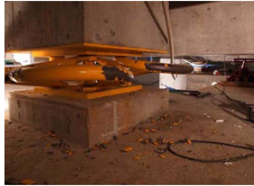
鋼棒ダンパーの塗装の剥がれ
