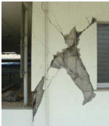
柱のせん断破壊
