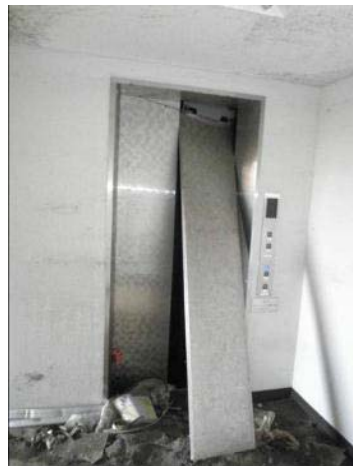
津波がシャフトを遡上し、 扉を突き破って吹き出す。
