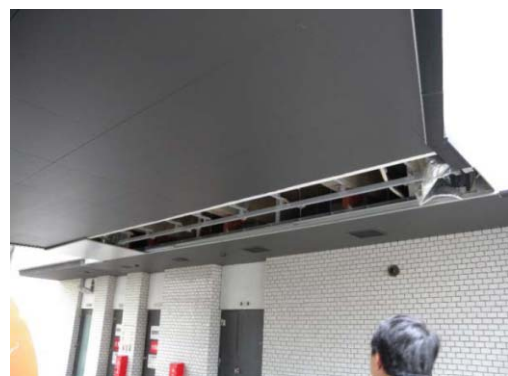
天井カバーの脱落
