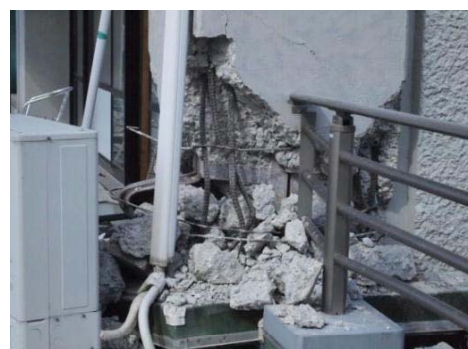
東側妻壁南側の外柱の被害状況
