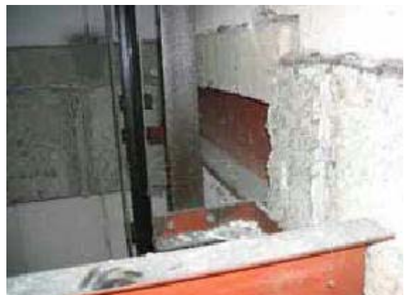
シャフト内壁面の耐火材が剥がれ落下
