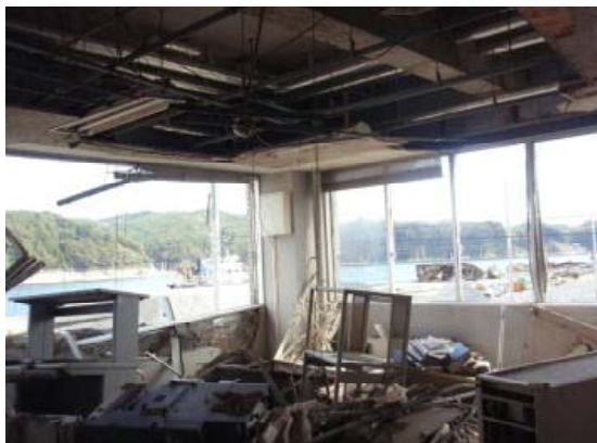
津波により内装が激しく損傷
