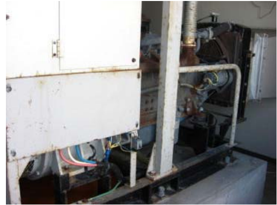
低層階の自家発電設備が浸水し停止
