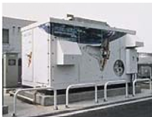
燃料電池システム(リン酸型)
