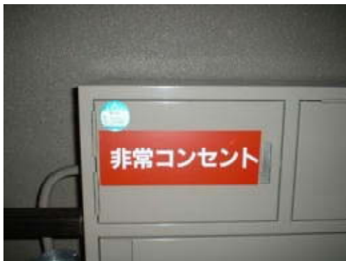
非常用コンセント
