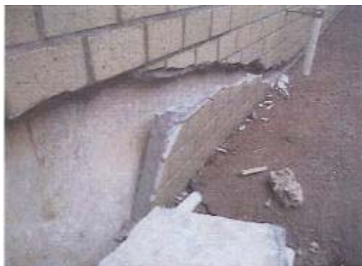
外壁タイルの剥落
