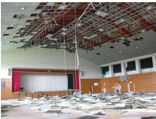
体育館での天井材・下地材の脱落
