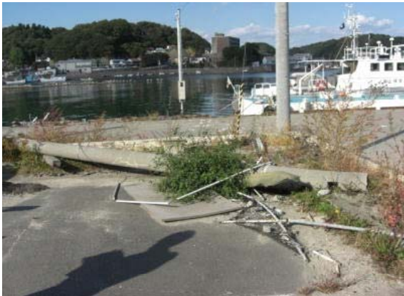
電力引き込み柱が津波により倒壊
