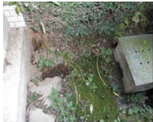
排水管と排水ますの間に断絶
