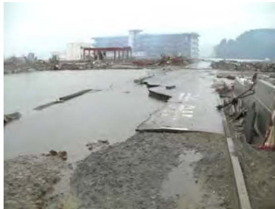
大動脈の国道45号が寸断(南三陸町)
