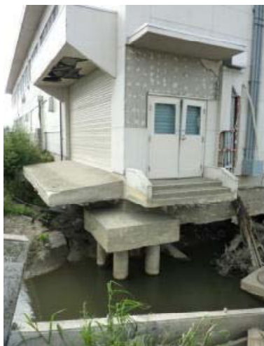
洗掘より杭頭が露出
