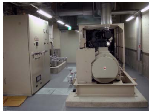
自家発電設備
