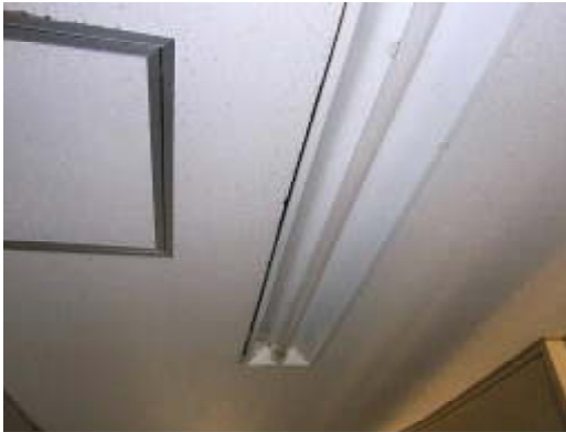
照明器具のずれ
