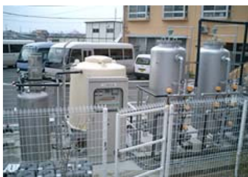
深層地下水利用システム
