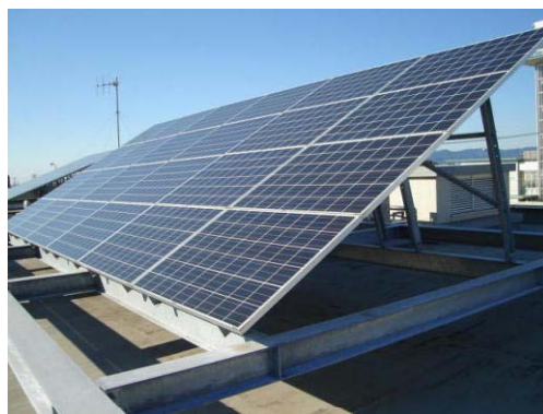
太陽光発電設備
