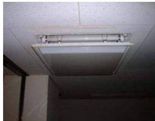
照明器具カバーの脱落
