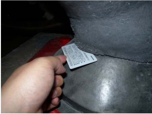
鉛ダンパーのひび割れ状況
