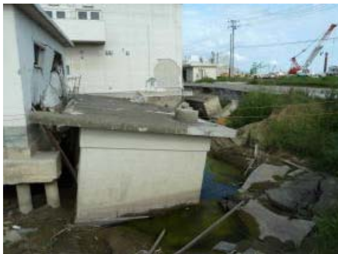
附属建物の流出、隣棟への衝突
