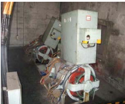
エレベーター機械室の巻上機が転倒
