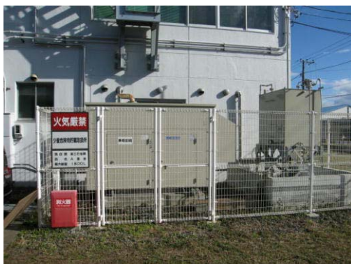
自家発電設備
