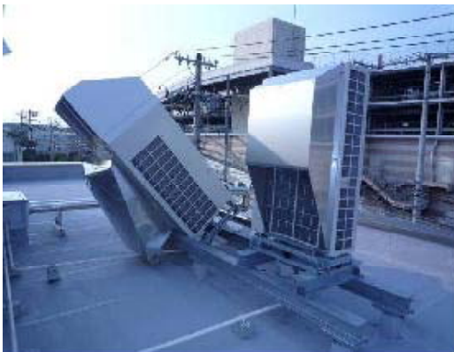
屋外機基礎のボルトが外れ転倒
