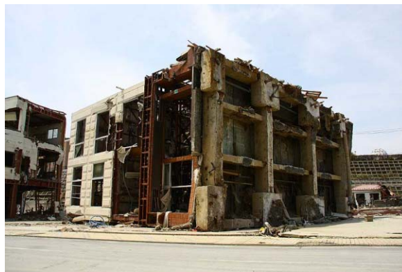
引き波で浮上し、横倒しとなったビル
