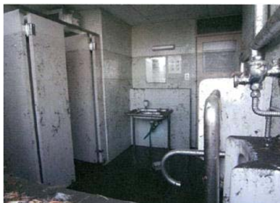
津波による内装の汚損
