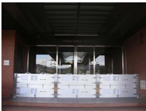
庁舎入口に設置された止水板
