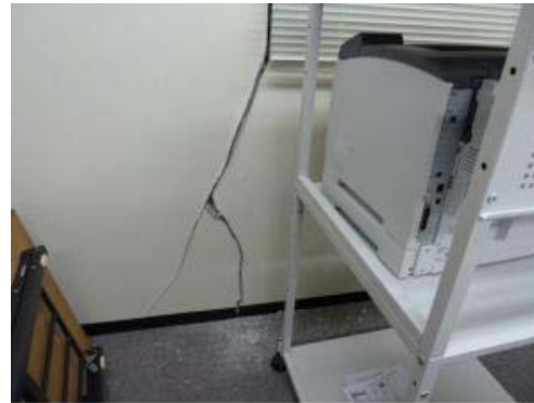
内部ボード壁のひび割れ
