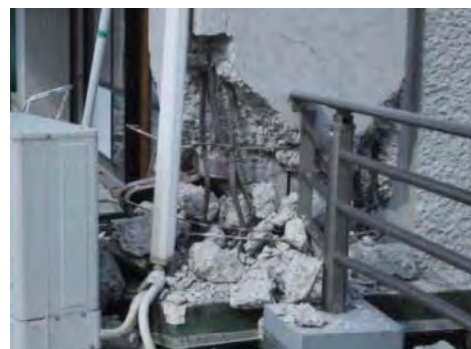
東側妻壁南側の外柱の被害状況
