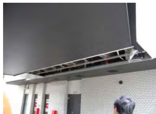
天井カバーの脱落
