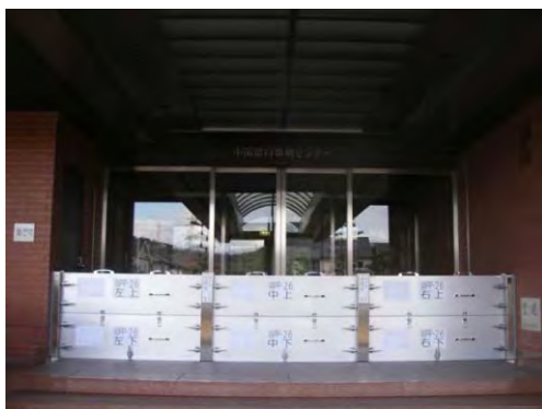
庁舎入口に設置された止水板
