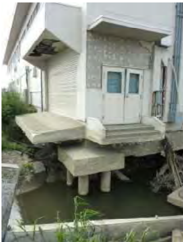
洗掘より杭頭が露出
