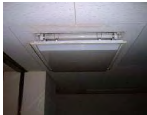
照明器具カバーの脱落
