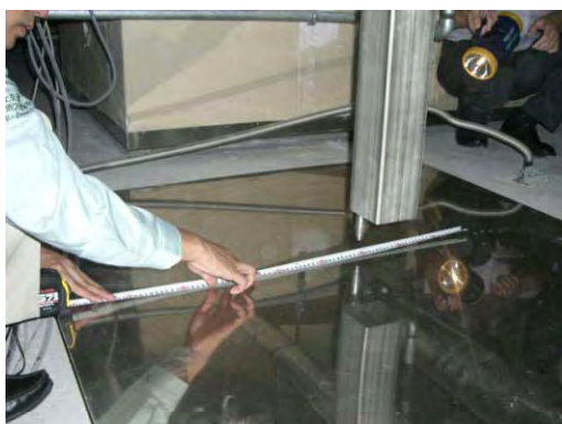
免震のけがき式変位記録装置
