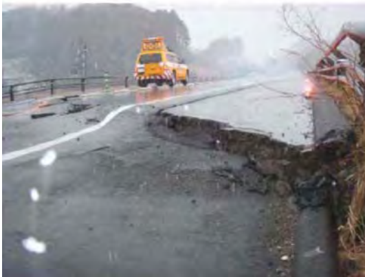
三陸自動車道での段差(石巻市内)
