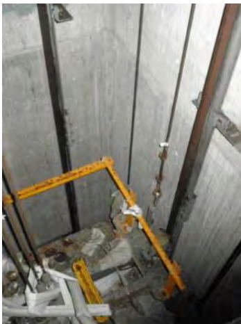
シャフト内が浸水し、 ロープが錆びている。
