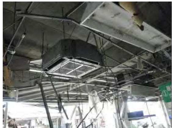
津波により天井の機器が損壊
