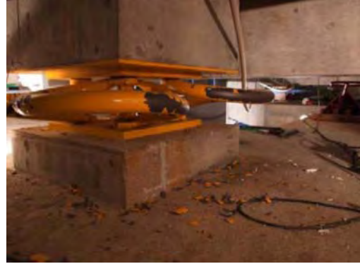
鋼棒ダンパーの塗装の剥がれ
