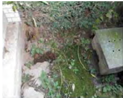
排水管と排水ますの間に断絶
