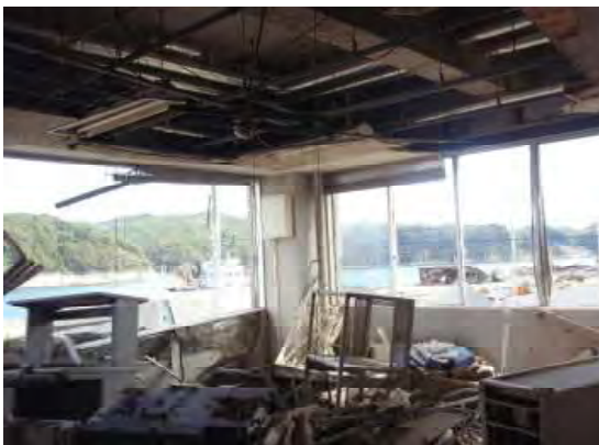
津波により内装が激しく損傷
