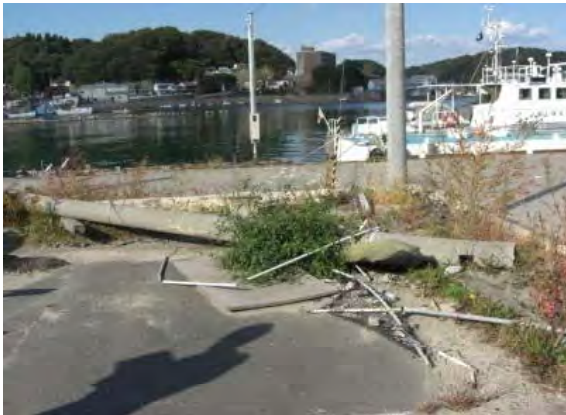
電力引き込み柱が津波により倒壊
