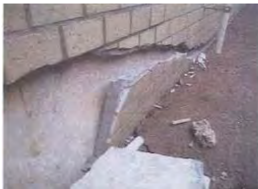
外壁タイルの剥落
