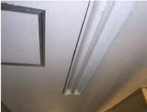
照明器具のずれ
