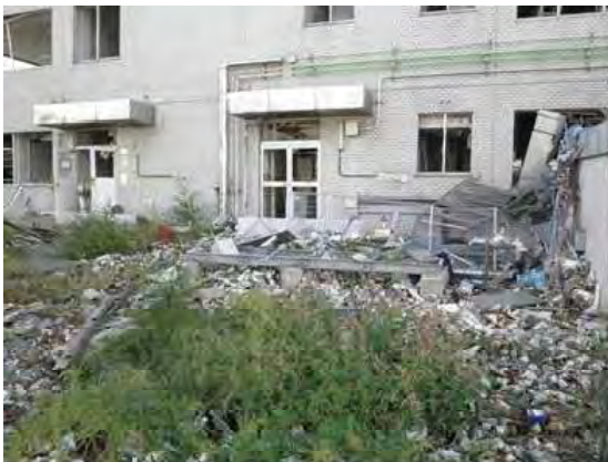
受水槽が流出し基礎のみが残る。
