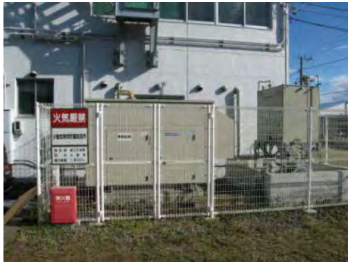
自家発電設備
