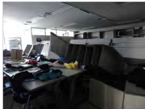
地震による室内家具の転倒
