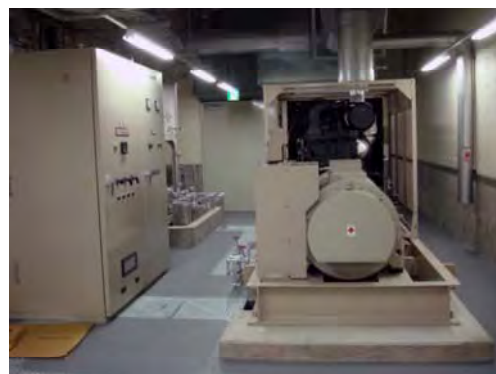
自家発電設備
