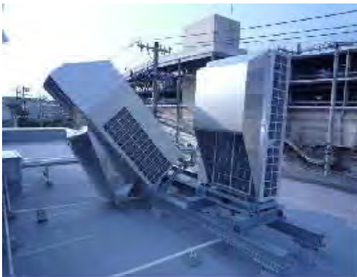
屋外機基礎のボルトが外れ転倒
