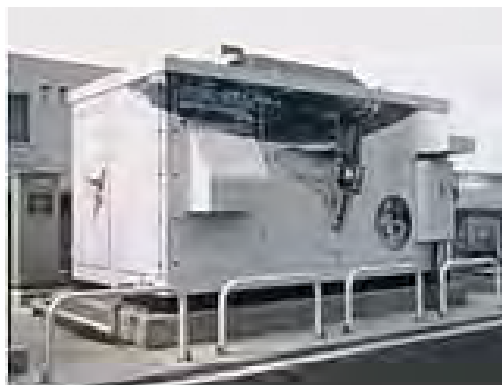
燃料電池システム(リン酸型)
