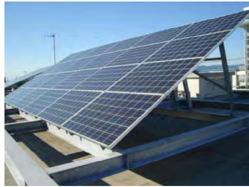
太陽光発電設備
