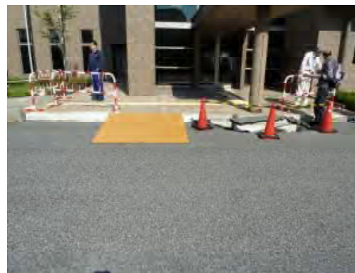
建物周囲での地盤沈下
