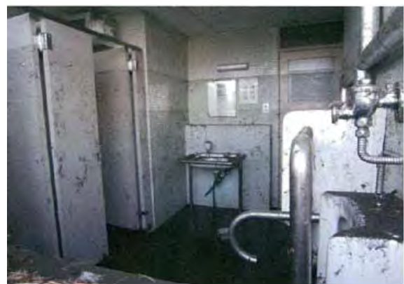
津波による内装の汚損
