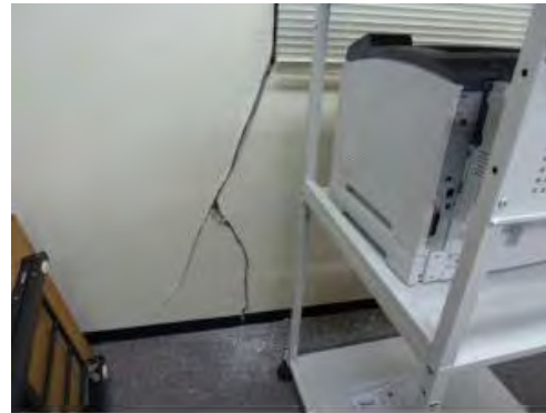
内部ボード壁のひび割れ
