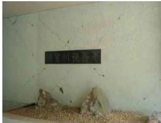
耐震壁のせん断ひび割れ
