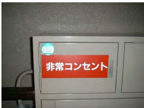
非常用コンセント
