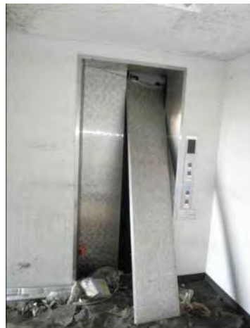
津波がシャフトを遡上し、 扉を突き破って吹き出す。
