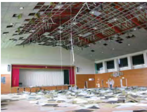
体育館での天井材・下地材の脱落
