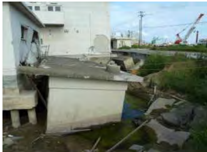
附属建物の流出、隣棟への衝突
