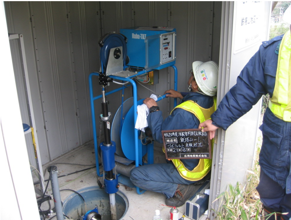
自動観測機器（ロボティルト）の点検状況
