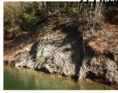
八橋小道下(法面崩落状況を確認)
