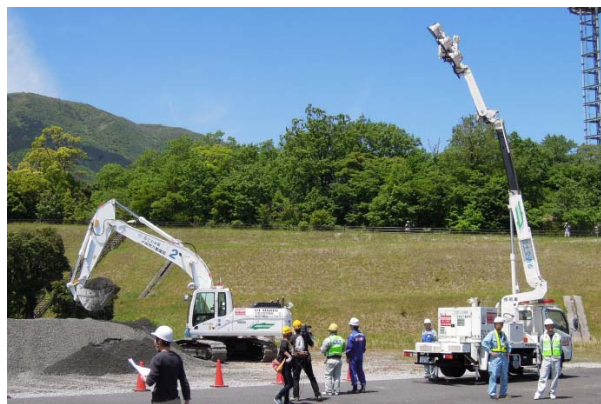
照明車(右側) 夜間作業を想定した訓練
