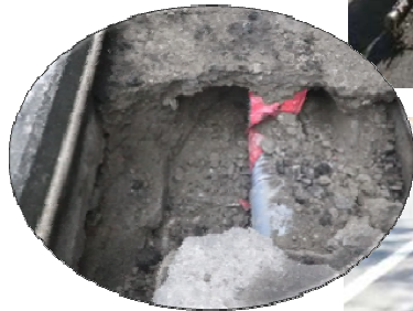
陥没箇所を開削し 空洞状況を確認
