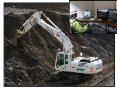
平成25年度 奈良県五條市の土砂崩落現場で活動
