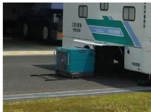
発電設備(室内用)
