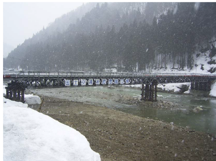
H16 台風23号災害 岐阜県飛騨市宮川町内国道360号で架設された応急組立橋
