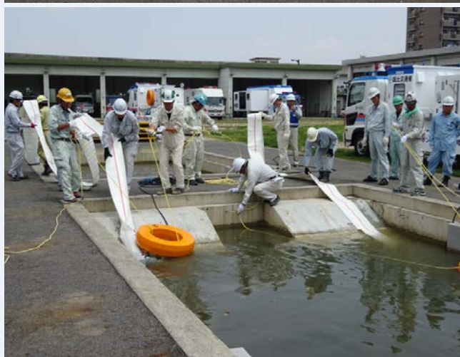
排水ポンプ車設置操作訓練
