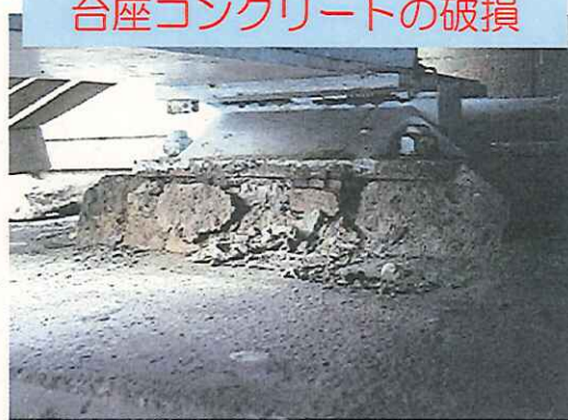
台座コンクリートの破損
