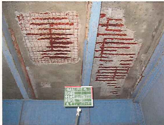
剥離鉄筋露出
