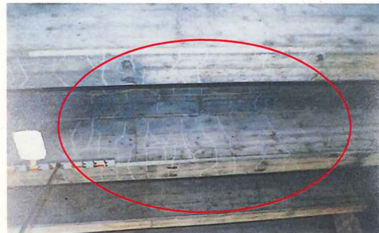
③ 支間中央部のひび割れ
