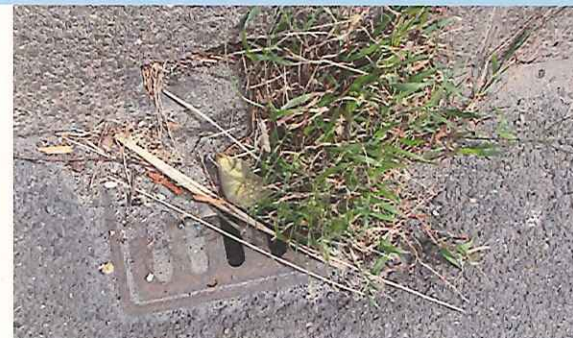
排水ますの、土砂などによる詰まり
