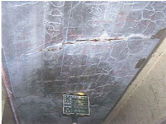
ひび割れからの漏水・遊離石灰
