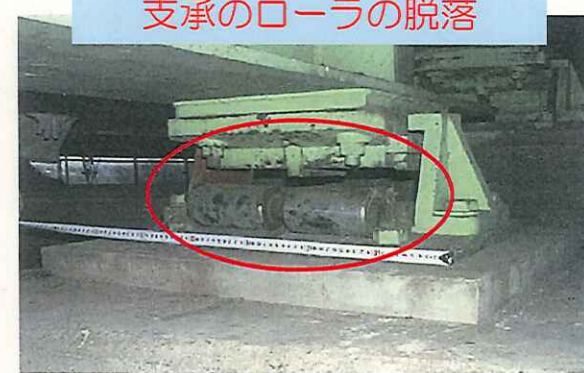
支承のローラの脱落
