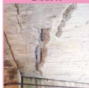
RC床版うき・剥離状況
