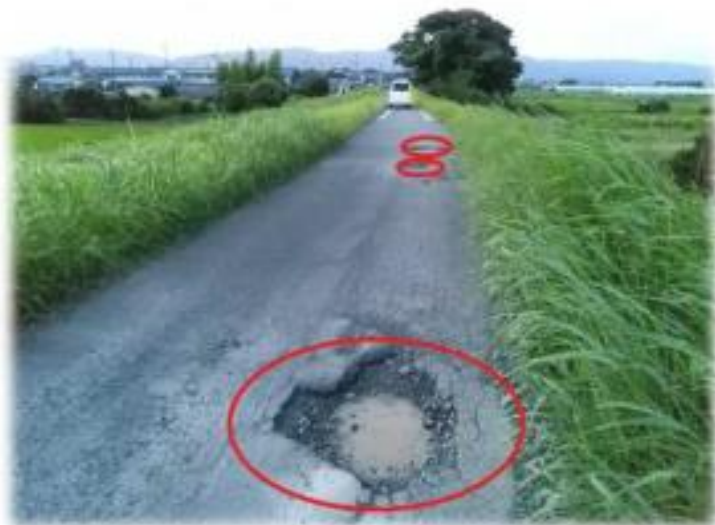
道路の陥没（舗装穴）の検知
