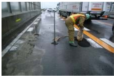
道路損傷の補修
