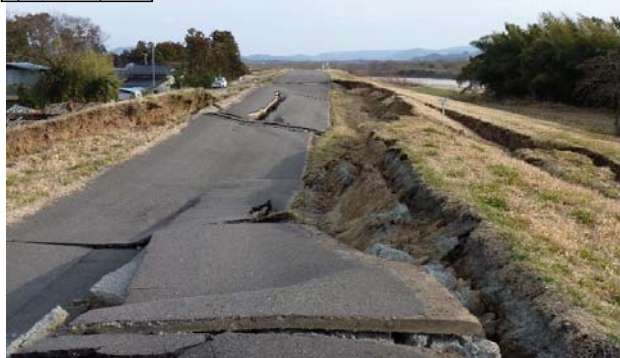
東日本大震災における阿武隈川の被災状況 (宮城県伊具郡丸森町)
