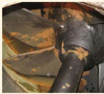
ポンプ設備のインペラ
