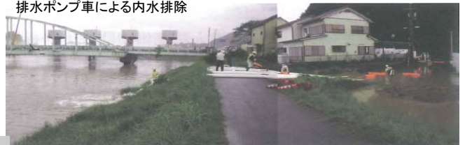
三重県紀宝町鮎田地区において、24時間体制で排水ポンプ車による内水排除を実施(日本建設機械化協会中部支部他)
