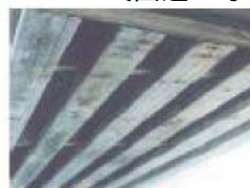
1980年(15年経過): 主桁下面にひびわれ、 錆汁発生
