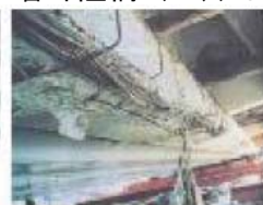
1991年(26年経過): 主桁PC鋼材の破断
