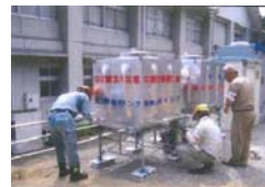
地元自治体の要望により、給水タンクを地元中学校に設置(日本道路建設業協会中部支部他)
