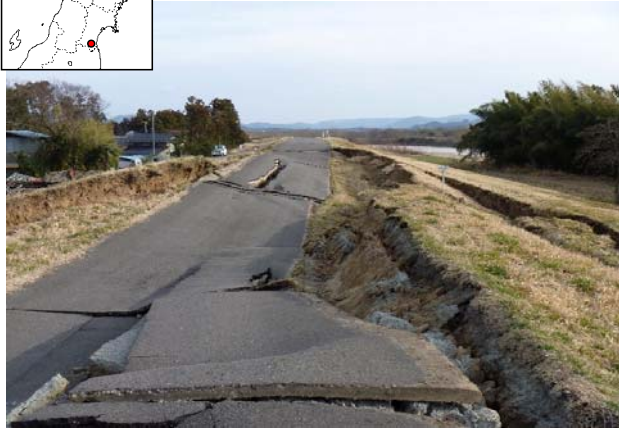
東日本大震災における阿武隈川の被災状況 (宮城県伊具郡丸森町)
