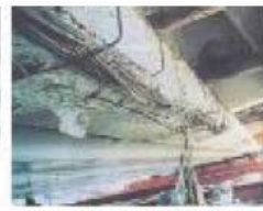
1991年(26年経過): 主桁PC鋼材の破断
