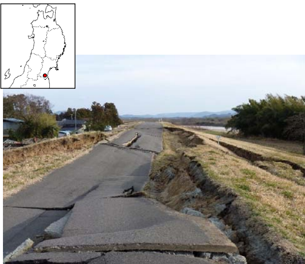
東日本大震災における阿武隈川の被災状況 (宮城県伊具郡丸森町)
