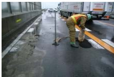
道路損傷の補修
