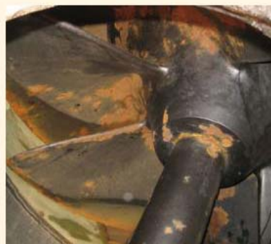
ポンプ設備のインペラ
