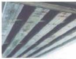
1980年(15年経過): 主桁下面にひびわれ、 錆汁発生
