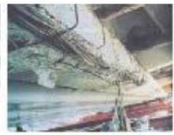
1991年(26年経過): 主桁PC鋼材の破断
