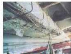
1991年(26年経過): 主桁PC鋼材の破断
