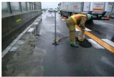
道路損傷の補修
