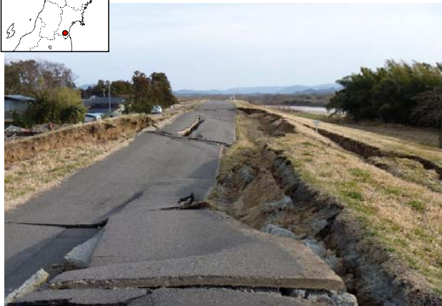
東日本大震災における阿武隈川の被災状況(宮城県伊具郡丸森町)
