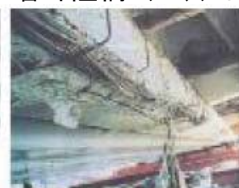
1991年(26年経過): 主桁PC鋼材の破断
