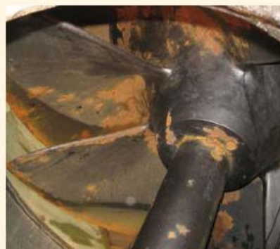
ポンプ設備のインペラ
