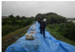
庄内川堤防洗掘箇所において、被害の拡大防止のため、応急処置として大型土のうを設置(建設業協会他)
