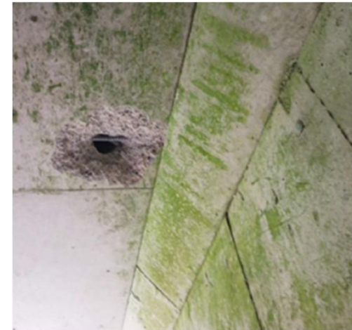
損傷したボックスカルバート写真
