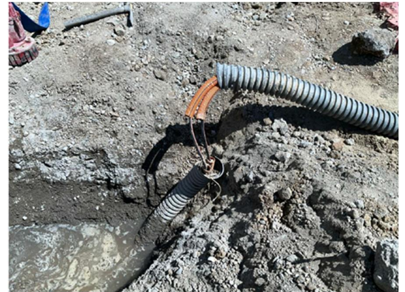
損傷した光ケーブル写真
