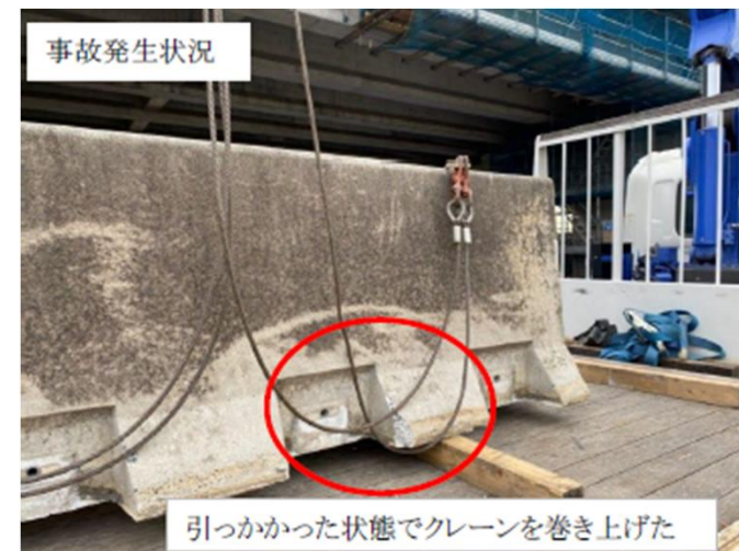
事故発生状況写真（再現）
