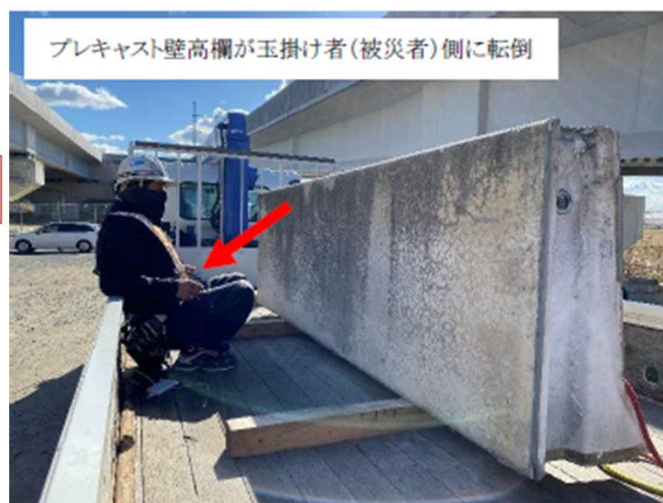
事故発生状況写真（再現）
