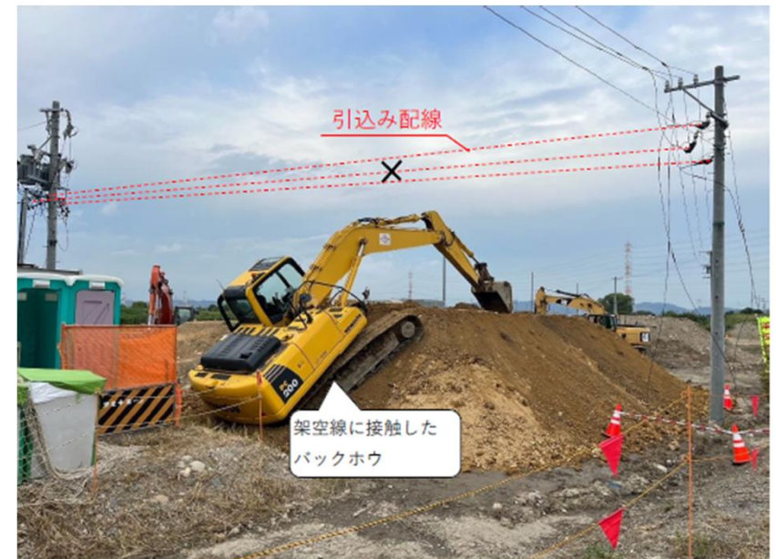
事故時の状況写真(再現)
