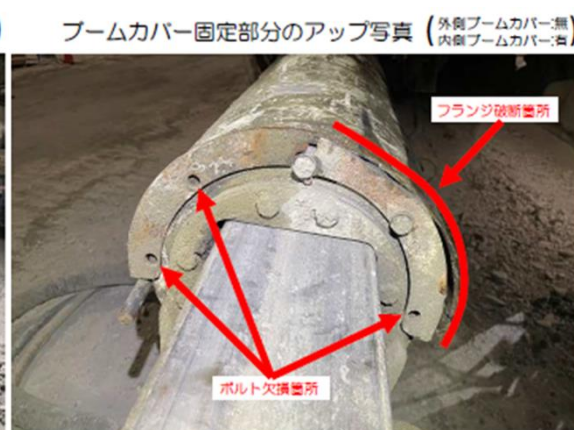
ブームカバー固定部 （ボルトの欠損箇所）
