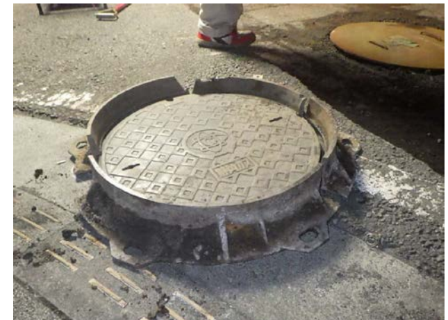
マンホール蓋受枠の損傷
