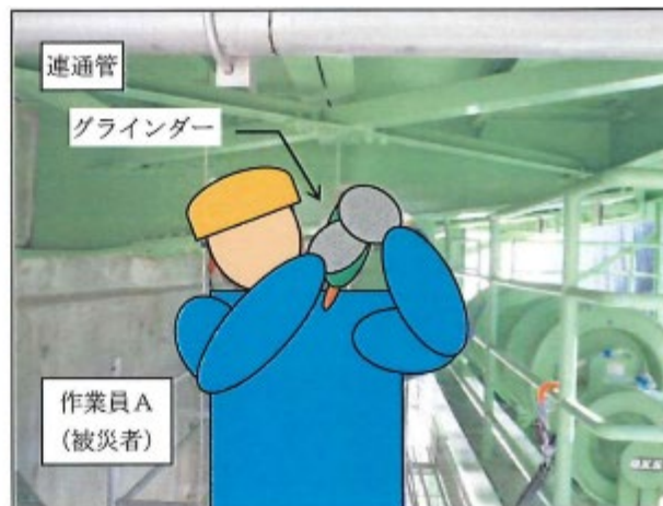
被災状況写真（再現）
