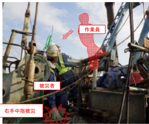
事故発生状況
