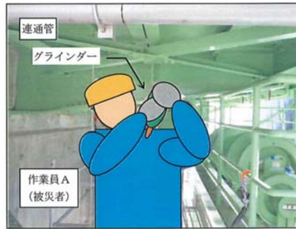
被災状況写真（再現）
