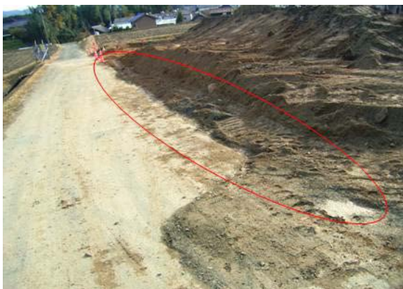
道路境界がはっきり分らない。 土砂も道路に流出している。
