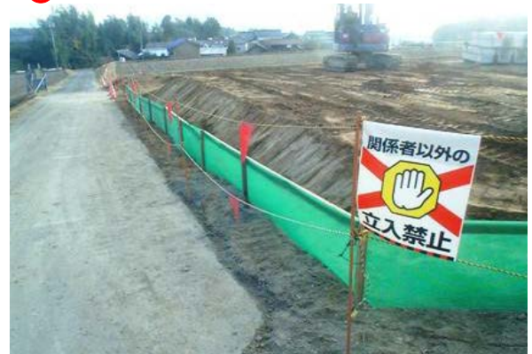
境界境に、土砂流出防止柵を設置し、 道路を安全に管理している良い例。
