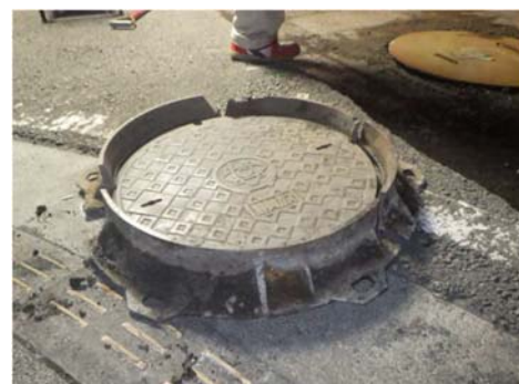
マンホール蓋受枠の損傷
