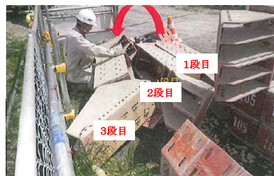
事故発生状況
