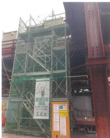
昇降設備全景
